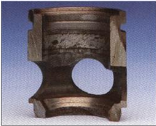
تآكل في جلبة صمام تصريف الضغط
