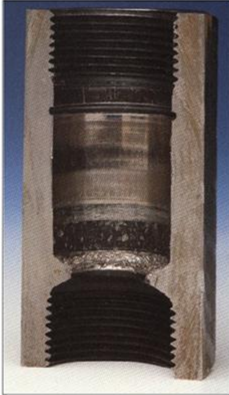
تآكل في صمام عدم الرجوع
