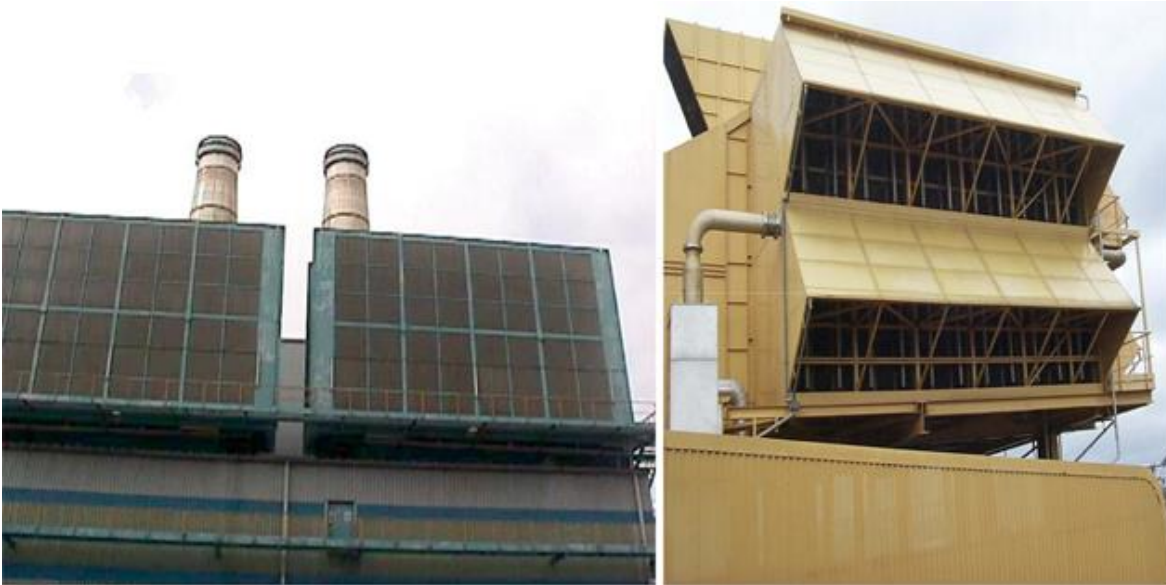
الشكل ( ٣٤ ) بيت مرشحات سحب أو مدخل الهواء Air intake filter house
