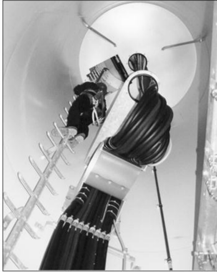
الشكل رقم (٧) : تثبيت الكابلات بقفيز حديدي
