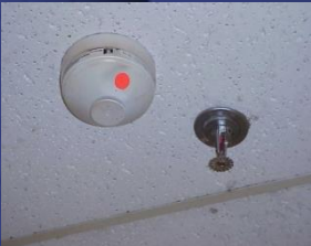
رشاشات الحريق في الأسقف
