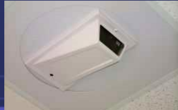
شكل الكاميرا بعد تثبيتها فى السقف
