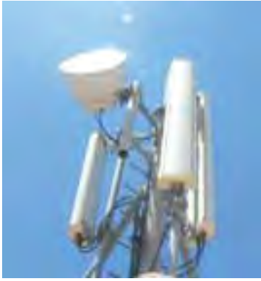
شكل (٣٠) : برج اتصال خلوي بثلاثة هوائيات قطاعية
