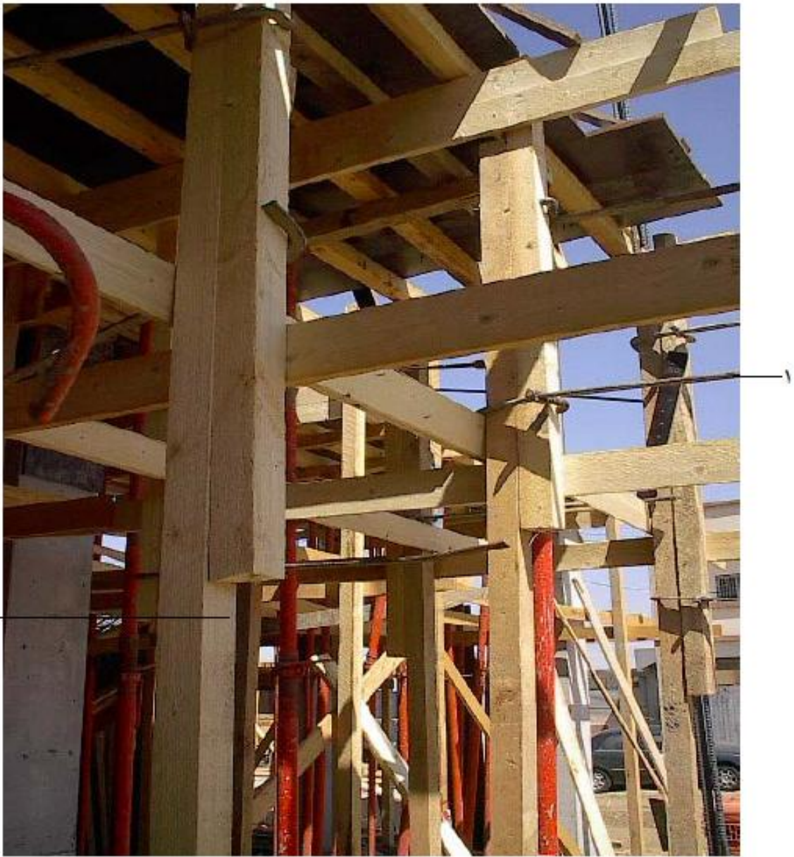
شكل رقم ( ٢١ ) استخدام القمط الحديدية في عمل ضفدعة (وصلات) رأسية لقوائم الأعمدة ١ - قمط حديدية ٢ - عروق ثم عمل وصلات رأسية لها (ضفدعة)
