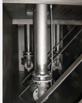
داخل خزان الزيت
