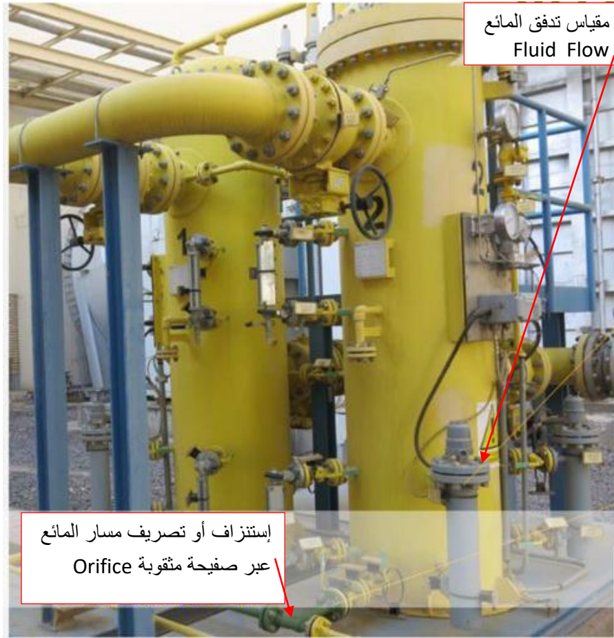
معدات مرشح (فلتر) الفصل Separator filter equipment
