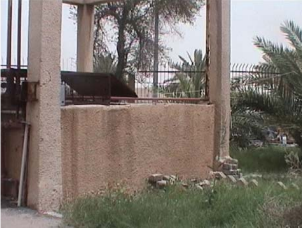
شكل يوضح خزان أرضي مرتفع جزء منه عن سطح الأرض
