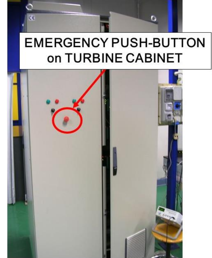
زر ضغط الطوارئ EMERGENCY PUSH BUTTON على لوحة كابينة التوربين Turbine Cabinet Panel
