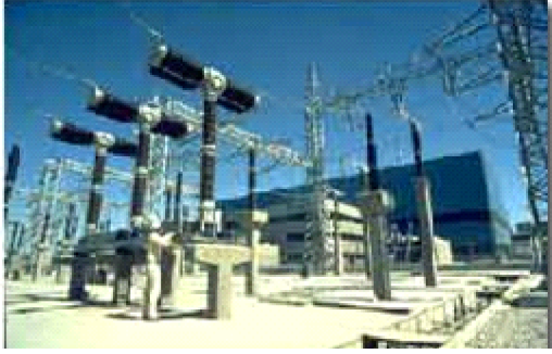
شكل (18): صورة لمحطة محولات
